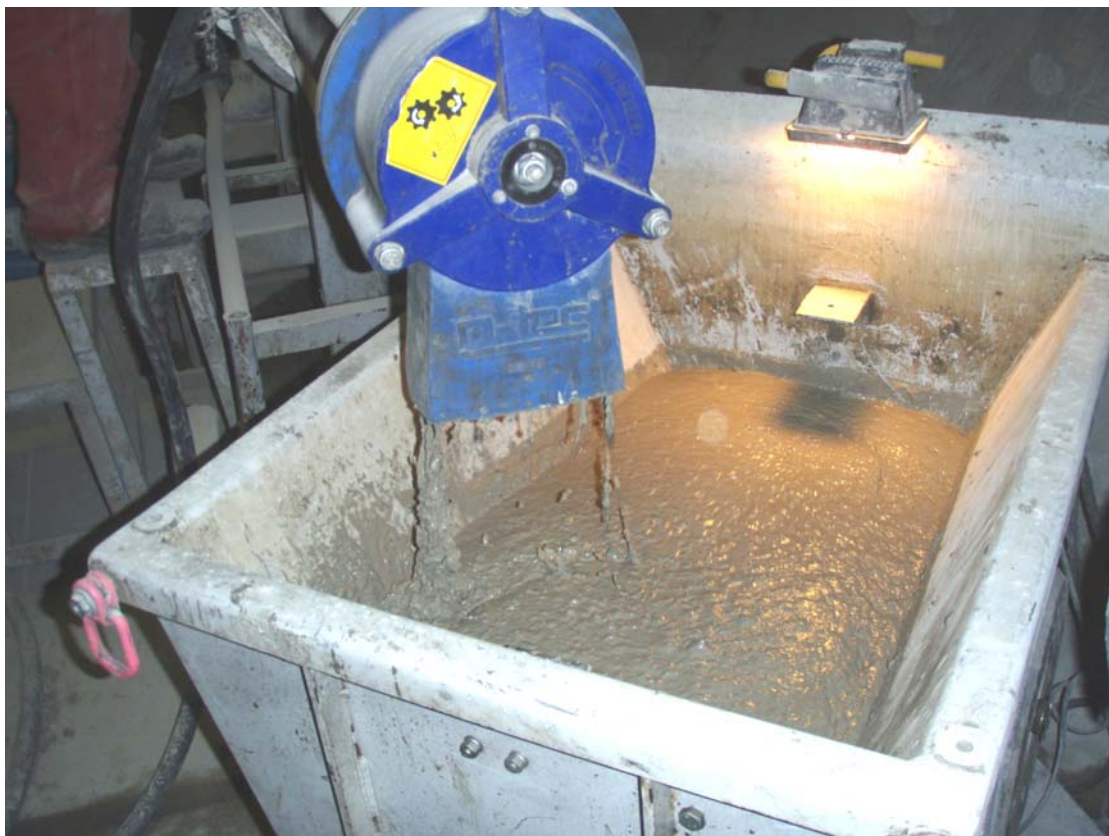
Fra gennemløbsblanderen falder betonen direkte ned i snækkepumpen
