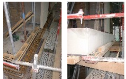
Typisk renoveringsstøbning på en gesims med V1/160 (B45). Disse arbejder udføres normalt kun med en tilslutningsarmering til altanskiven samt en bøjle til gesimsen.
