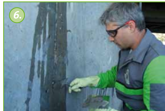
6. Revneforløbet lukkes med KÖSTER KB-Fix 5. Lukning af revnen forhindrer injektionsmaterialet i at flyde for tidligt ud af revnen under injektionen. Forarbejdningstiden er ca. 5 minutter afhængigt af omgivelsernes temperatur og luftfugtighed.
